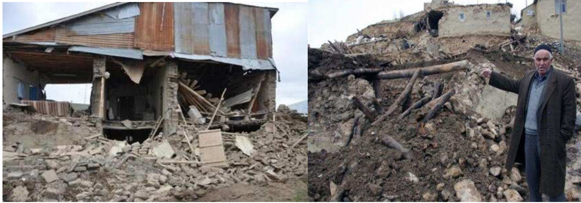
Şekil 2. Elazığ'da Yıkılan Kerpiç Evler
