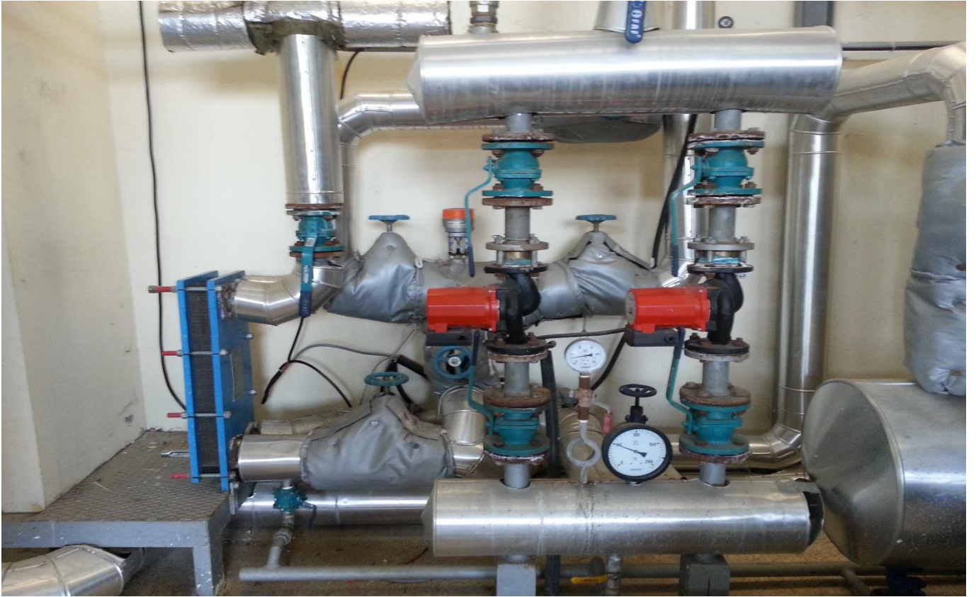
Şekil 6. Eşanjör ve bina içi sirkülasyon pompaları
