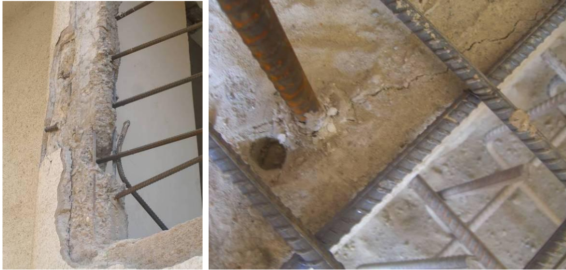
Şekil 1. Güçlendirilen Bazı Yapılarda Beton Kalitesi ve Ankraj İşçiliği
