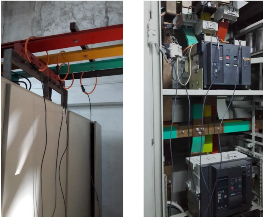
Şekil 10. Ölçüm alınan fabrikaya ait transformatöre akım ve gerilim problemlerinin bağlanması
