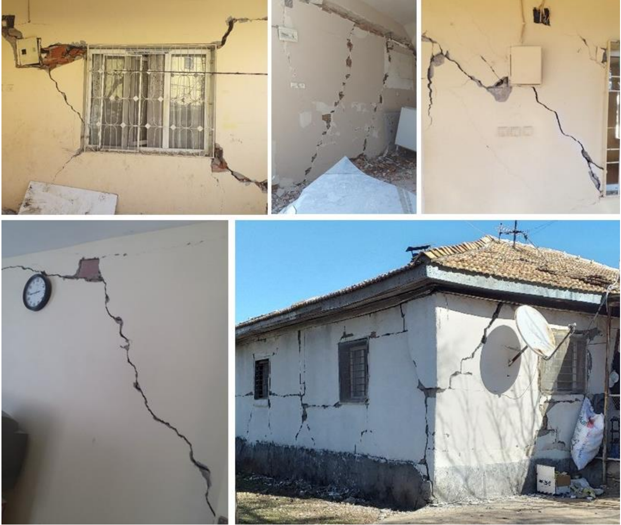
Şekil 10. Düzlem İçi Duvar Hasarları İçin Örnekler
