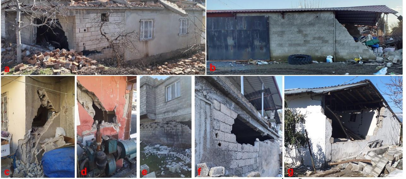
Şekil 11. Dış Duvarlarda Düzlem Dışı Devrilme Hasarları İçin Örnekler
