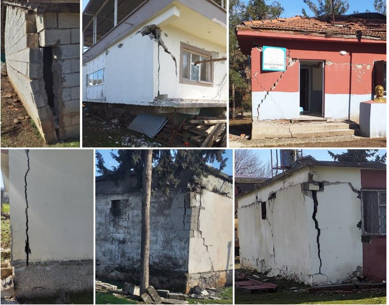
Şekil 8. Köşe Hasarları İçin Örnekler
