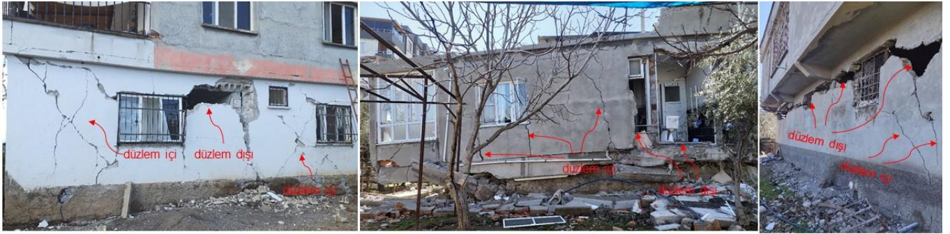
Şekil 12. Aynı Duvar Üzerinde Düzlem İçi Kesme Çatlakları ve Kopma Hasarı Durumu İçin Örnekler
