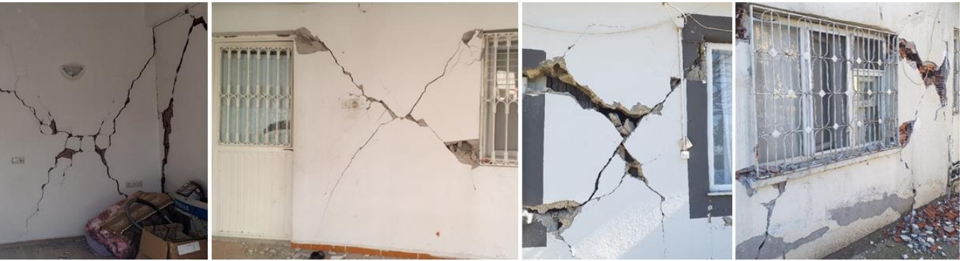
Şekil 9. \times Şeklindeki Çatlak Biçimi İçin Örnekler
